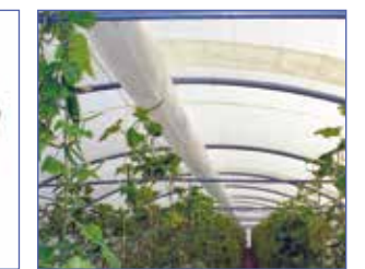
Tubulaire pour la ventilation des serres
